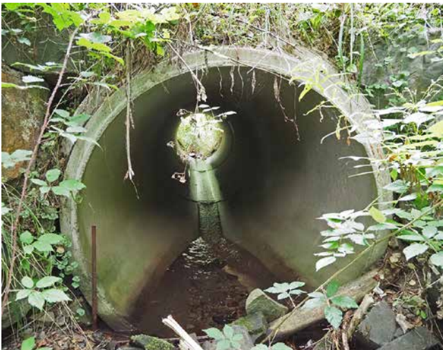
Abb. 9: Durchlass ohne natürliche Gewässersohle. Aufgrund des fehlenden Sohlsubstrats und des geringen Wasserstands ist dieser Durchlass für aquatische Organismen nicht passierbar. Positiv hervorzuheben ist die großzügige Dimensionierung des Rohres. Um eine Durchgängigkeit herzustellen, müssen Maßnahmen ergriffen werden, die im Durchlass zu einer natürlichen Sohle, höheren Wasserständen und einer größeren Strömungsheterogenität führen. (Foto: J. Wellhäuser)
