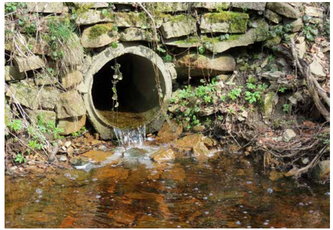
Abb. 3: Bereits kleine Abstürze schränken die Durchgängigkeit von Durchlässen stark ein. Selbst wenn der Absturz überwunden werden kann, scheitern Wasserorganismen an der Durchwanderung des glatten Betonrohres aufgrund hoher Fließgeschwindigkeiten, fehlender Strömungsheterogenität (Stillwasserbereiche für Schwimmpausen) und geringer Wasserstände. (Foto: M. Schmidt)
