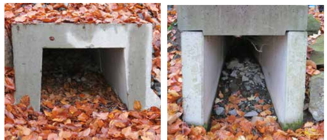
Abb. 16: Haubenprofildurchlässe ohne Fundamentstreifen. Auf dem linken Bild ist das Haubenprofil im unteren Bereich verbreitert und weist so eine erhöhte Standfestigkeit auf. Das rechte Bild zeigt einen Durchlass, der seitlich aus nach außen gedrehten L-Profilen und einem darauf verschraubten Deckel besteht. Beide Varianten wurden bisher nur auf sehr festem Boden verbaut. (Fotos: M. Schmidt)
