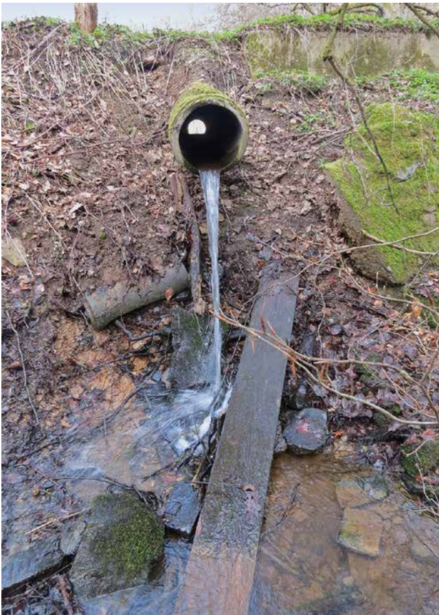
Abb. 19: Diese Verrohrung wurde vermutlich von Anfang an zu hoch eingebaut. Im Zusammenspiel mit der darauf folgenden Erosion ist eine unüberwindbare Barriere entstanden. (Foto: M. Schmidt)
