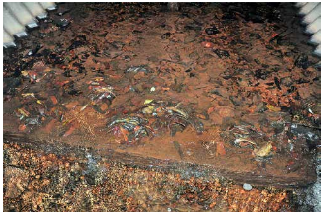
Abb. 21: Wellstahlprofil mit einem Sohlssubstrat, welches eine Durchwanderung ermöglicht. Die Sohle wurde durch schmale Querbalken stabilisiert, die seitlich und in der Mitte mit geringen Strömungsgeschwindigkeiten überflossen werden. Idealerweise würden die Querbalken abwechselnd rechts und links Abflachungen aufweisen, die das Wasser lenken und sehr gut passierbare Bereiche entstehen lassen.
