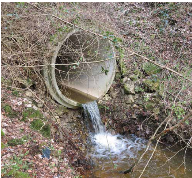
Abb. 10: Die erhöhten Fließgeschwindigkeiten im Durchlass führen zu einer fortschreitenden Erosion unterhalb des Durchlassausgangs. Der wachsende Absturz erhöht wiederum die Erosionskraft des Wassers. (Foto: M. Schmidt)
