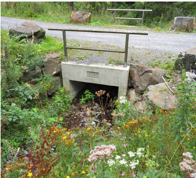
Abb. 14: Haubenprofildurchlass mit Geländer und Kopfbalken. Ein Geländer wird notwendig, wenn die potentielle Absturzhöhe größer als ein Meter ist. Der Kopfbalken, auf dem das Geländer steht, sichert den Wegekörper seitlich gegen Abrutschung ab. (Foto: J. Wellhäuser)
