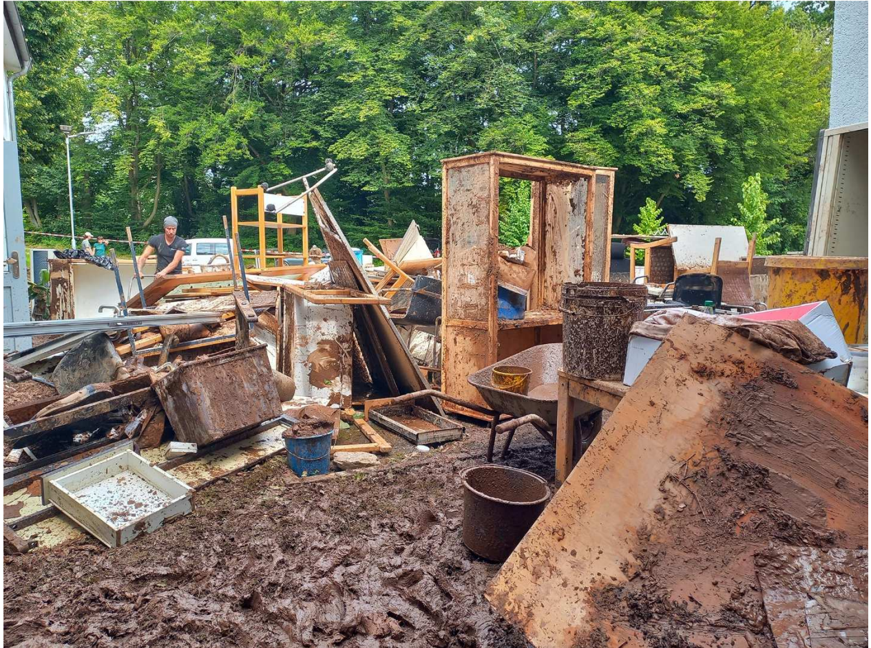
Foto 2: Aufräumarbeiten nach der Überschwemmung (Foto: Dr. Georg Leefken)
