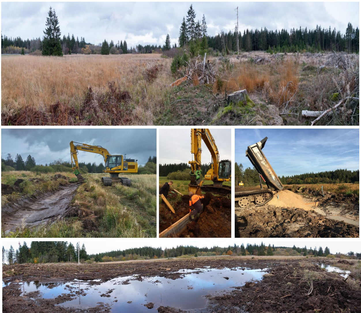
Abb. 22: Abfolge der Revitalisierung der Butterwiese: 1) Der Hauptgraben vor Beginn der Maßnahmen. Blick von West nach Ost. (Foto: Philipp Küchler). 2) Säubern des Grabens mit dem Kettenbagger. Das Material wurde nördlich des Grabens abgelegt. 3) Einbau vorgefertigter Holzspundwände. Mit der Baggerschaufel wird die positionierte Spundwand in den tonigen Untergrund gedrückt. 4) Verfüllen des Grabens durch einen Dumper. (Fotos 2-4: Maria Aljes) 5) Blick von Ost nach West nach Abschluss der Maßnahmen. Die Grabenfüllung wurde leicht überhöht, um dem späteren Sacken der Füllung nach vollständiger Durchfeuchtung Rechnung zu tragen. (Foto: Marco Lenarduzzi)
